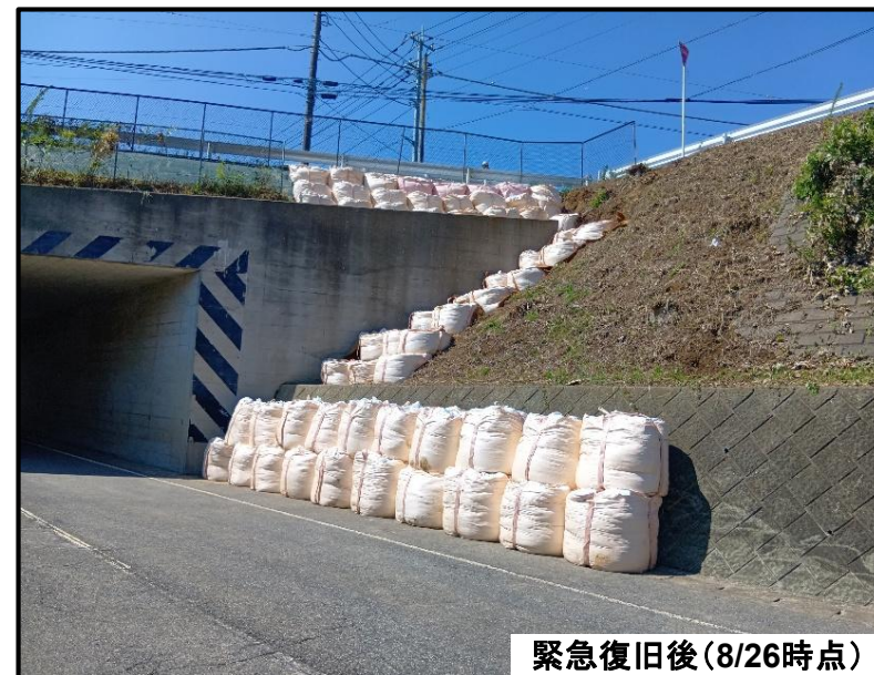
橋台背面の崩壊
