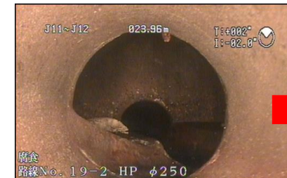
腐食した管きよ
