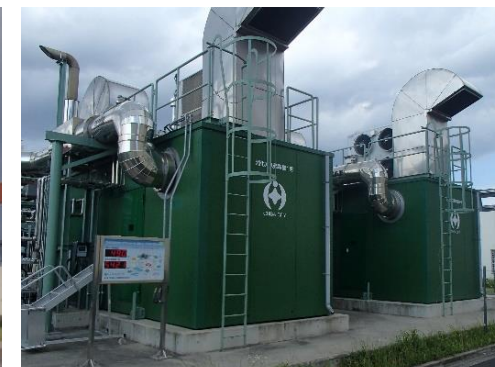
消化ガス発電設備
