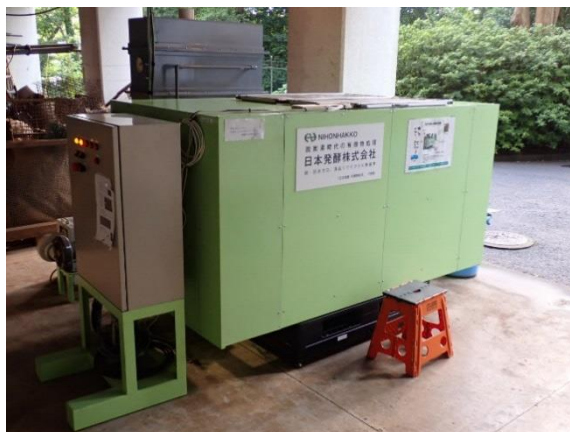
有機物処理機の設置状況
