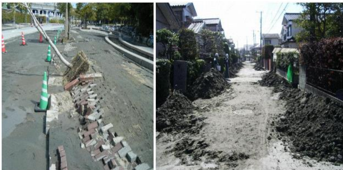
図表 18 千葉市美浜区での被災状況（2011 年（平成 23 年）東日本大震災）
