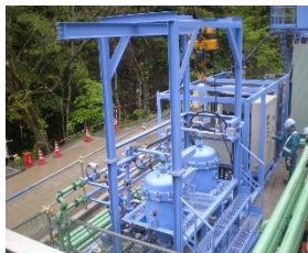
トンネル工事濁水
