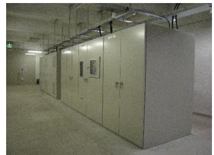
今回導入した回生電力貯蔵装置
