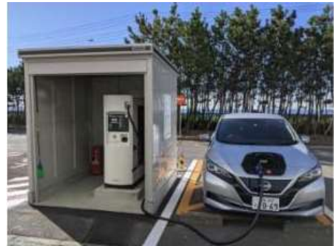
EV 充電設備
