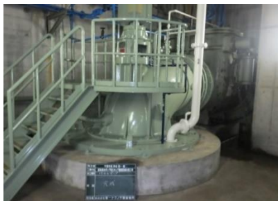
ポンプ場整備事業
