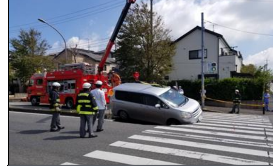
R 元 老朽化した管渠の損傷による道路陥没事故 (緑区あすみが丘)
