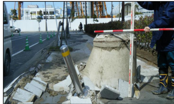
東日本大震災における被災状況
