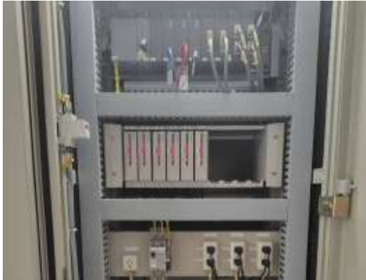
通信設備（平川浄水場）
