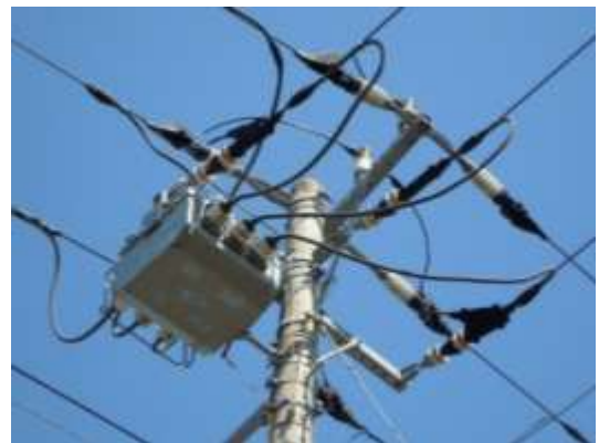
受変電・配電設備（大木戸浄水場）
