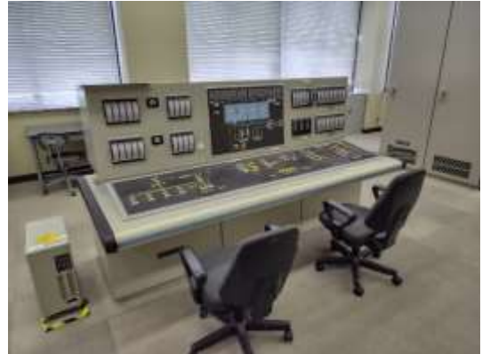
監視制御設備（大木戸浄水場）
