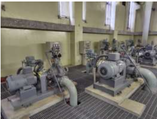
ポンプ設備（大木戸浄水場）
