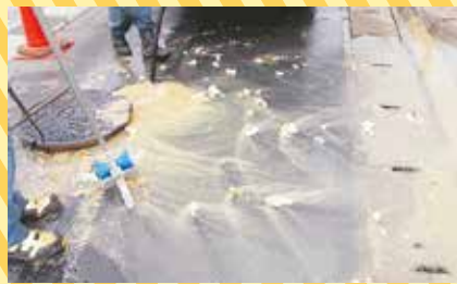
油により下水道管が詰まりマンホールからあふれた汚水
