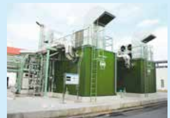
南部浄化センターの発電設備
