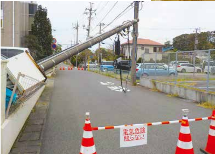
◀東日本台風による電柱の転倒（中央区都町）
