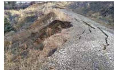
盛土の割れ目
