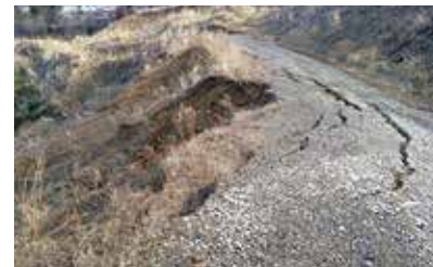
盛土の割れ目
