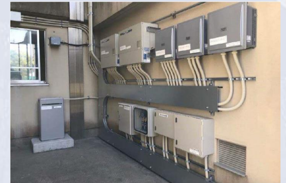
蓄電池・パワーコンディショナー等
