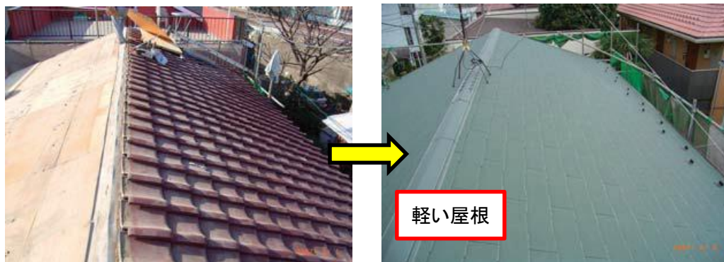
【耐震改修工事事例写真】 筋交いによる壁の補強(左)、軽い屋根への改修(右)
