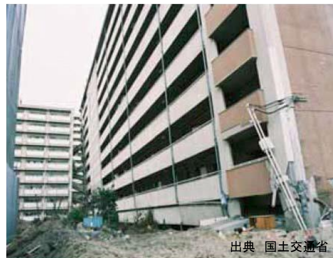
阪神・淡路大震災の建物被害(マンション) 出典 国土交通省
