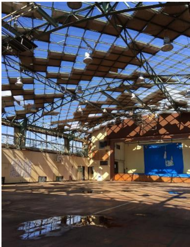
屋根が吹き飛んだ体育館（稲浜小）
