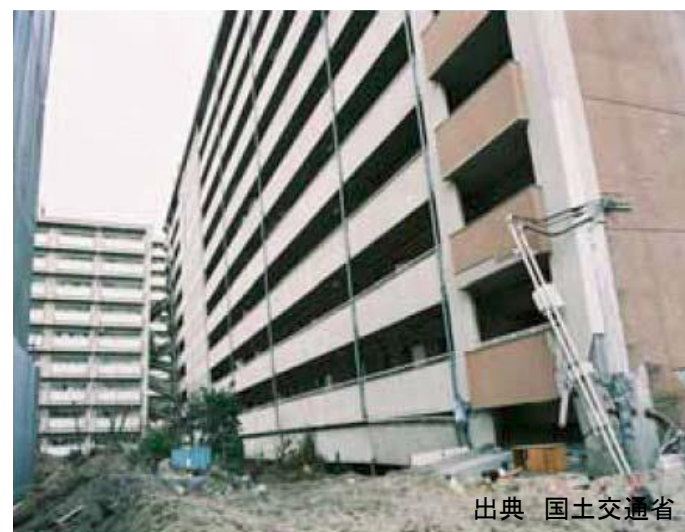
阪神・淡路大震災の建物被害(マンション) 出典 国土交通省
