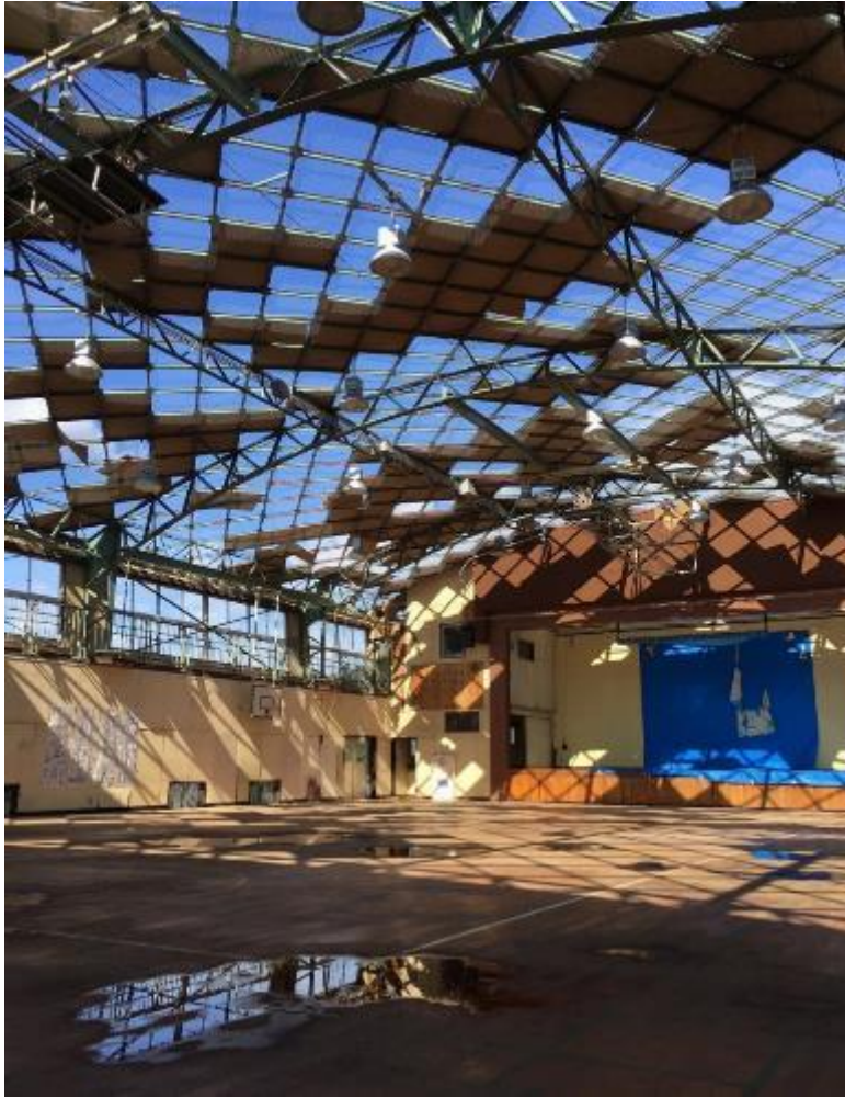
屋根が吹き飛んだ体育館（稲浜小）
