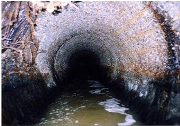
劣化した下水道管 (2)
