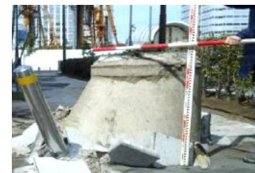
◀【課題】 地震で浮いたマンホール
