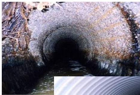
◀【課題】 老朽化した下水道管
