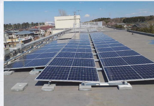
太陽光パネル
