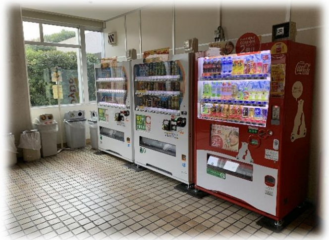
■図表 4-24 自動販売機の設置例（本庁舎1階ロビー）
