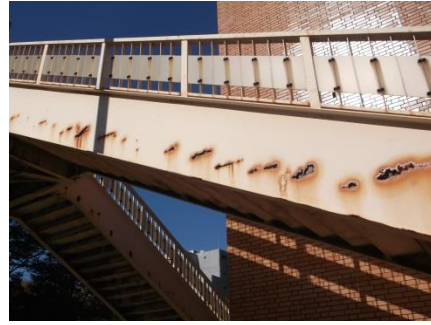
老朽化の状況
