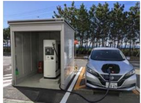
EV 充電設備
