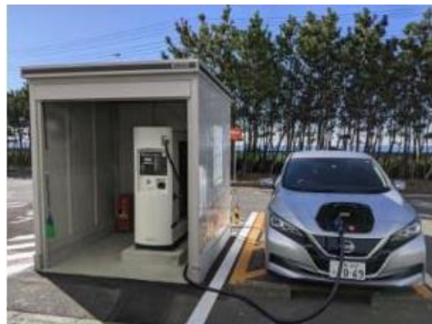
EV 充電設備
