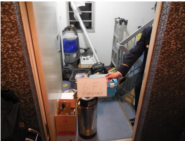
除去を命令した避難階段の状況①
