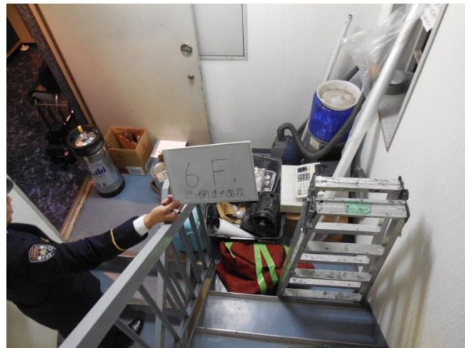
除去を命令した避難階段の状況②
