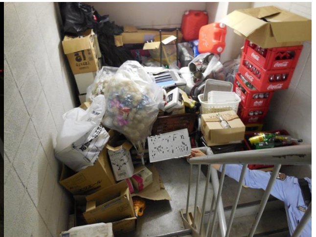
除去を命令した避難階段の状況
