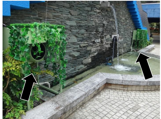
屋外空調機器
