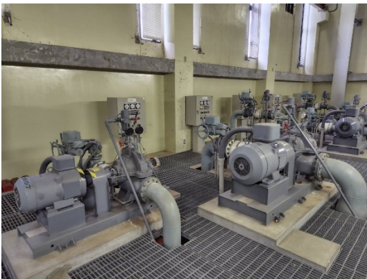
ポンプ設備（大木戸浄水場）
