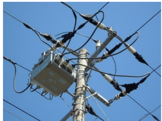
受変電・配電設備（大木戸浄水場）
