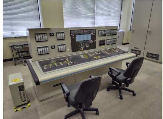
監視制御設備（大木戸浄水場）
