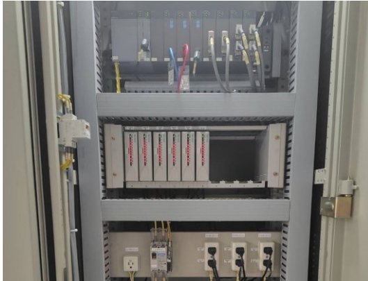
通信設備（平川浄水場）
