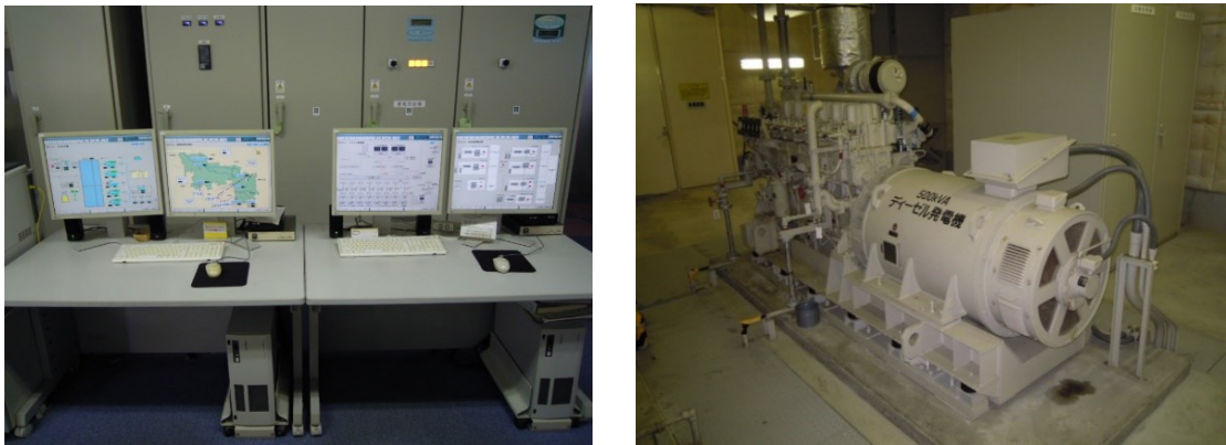
図 3-10 浄水場等の設備
