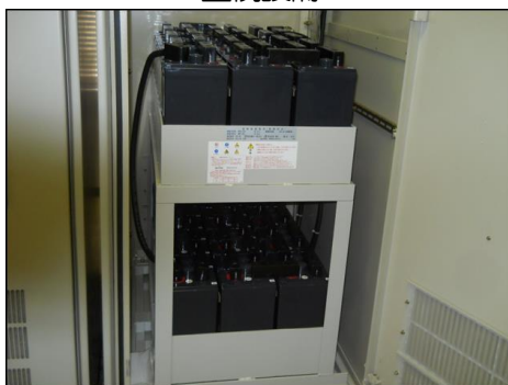
無停電電源設備
