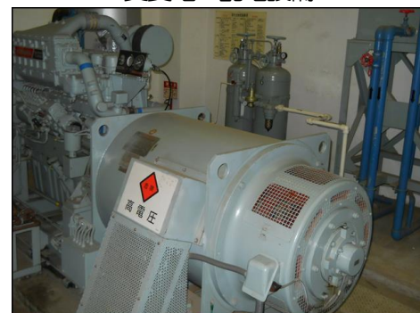
自家用発電設備
