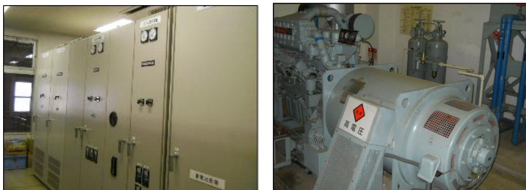
図 3-13 浄水場の設備
