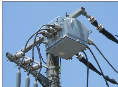
受変電・配電設備
