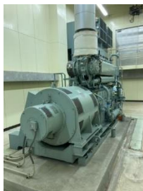
自家発電設備
