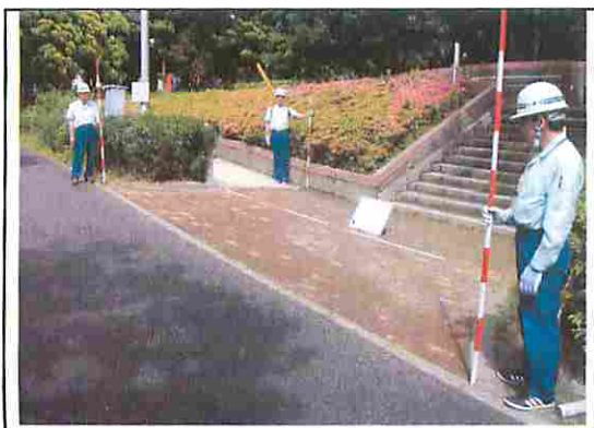
花見川緑地(被害状況) 歩道から階段に向かって陥没が確認された
