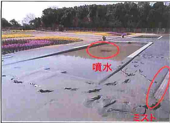
花の美術館噴水 (土砂噴出、地盤沈下により池底面が沈下110mm)
