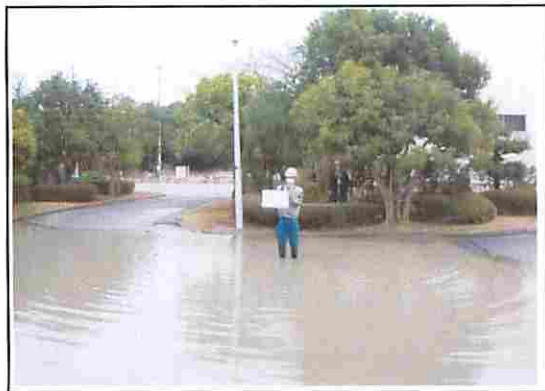
公園事務所 (AS舗装の段差 300mm)
