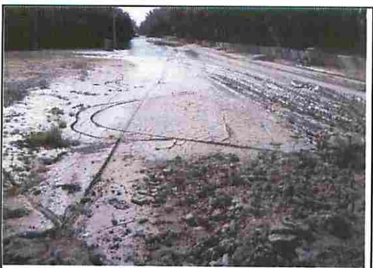
護岸道路(液状化による土砂噴出)
