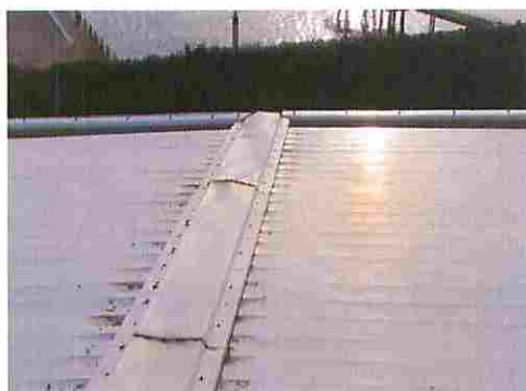
①屋根接合部破損状況
