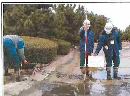
池の端部は、防水シートが持ち上げられ、 部分的に破れている箇所がみられた
