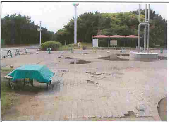
いなげの浜入口前(地面の隆起) 地面の隆起により、ブロック舗装のずれや AS舗装が破損
