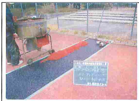
幕張海浜緑地 テニスコート ゴムチップ舗装 (復旧方法)部分的な復旧で対応
