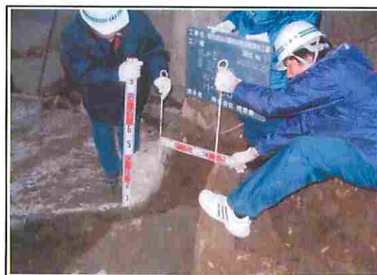
池底及び躯体の立上がり部分に、大きな破損箇所がみられた
