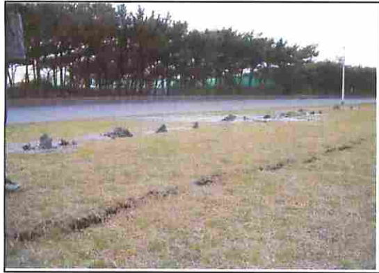
芝生広場(液状化発生時)
