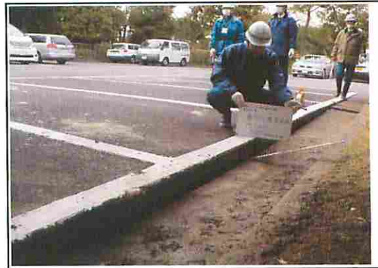
公園事務所駐車場 (AS舗装の段差 140mm)
