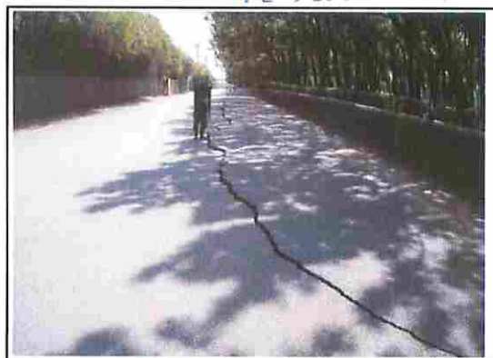
護岸道路(地面の亀裂)
