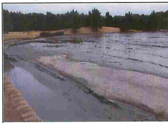
震災後の「浜の池」 防水機能が失われたため水がたまらない状態
