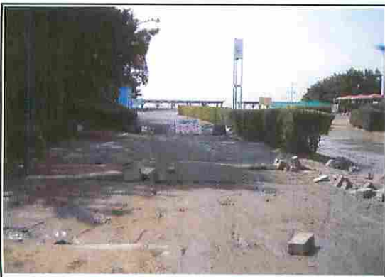
いなげの浜進入路 (液状化による土砂噴出)
