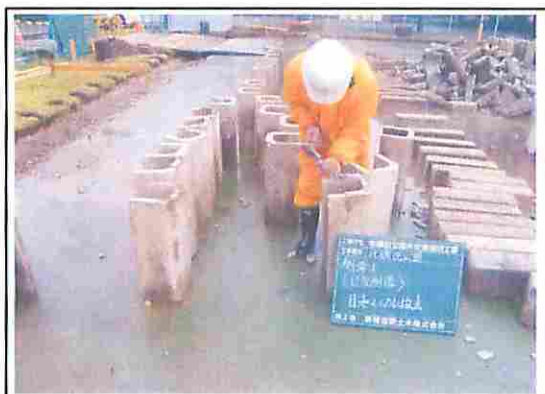
北磯辺公園(復旧方法) 再利用できる部材は、清掃後に再設置
