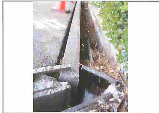
第1駐車場(側溝破損)
