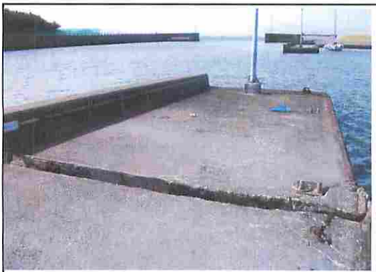
目地部分の断裂
