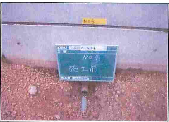
花の美術館展示棟裏 (排水管の座屈)
