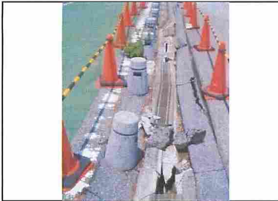
第1駐車場(地面隆起による側溝破損)
