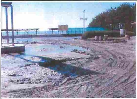
いなげの浜入口前 (液状化による土砂噴出)
