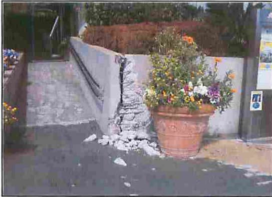
花の美術館メインエントランス手すり擁壁 (コンクリート擁壁の破損)
