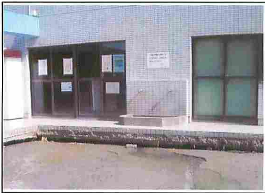
ビーチセンター(地盤沈下 370mm)
