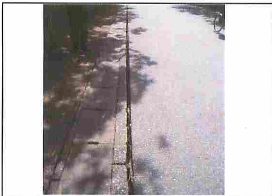
護岸道路(側溝と舗装間の空隙)
