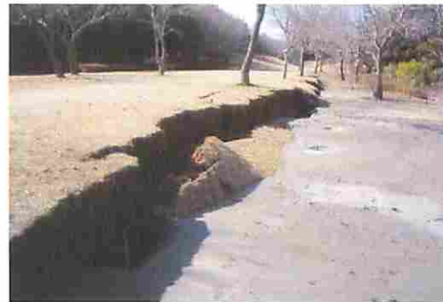
花見川緑地(隆起・陥没)
