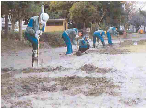
中磯辺公園 舗装の破損状況を確認するため、噴出土砂を取り除く
