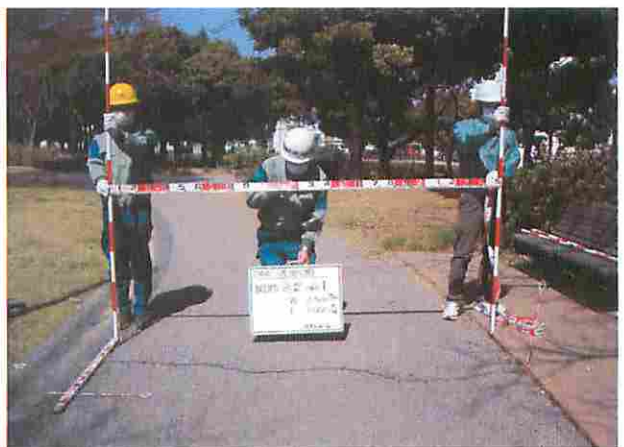
浜田公園 園路のクラックを測定
