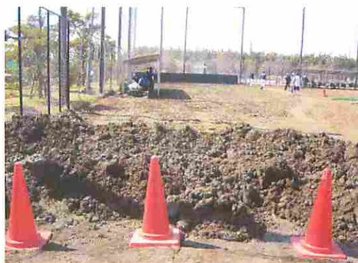
打瀬第3公園 噴出土砂が1箇所に集められた
