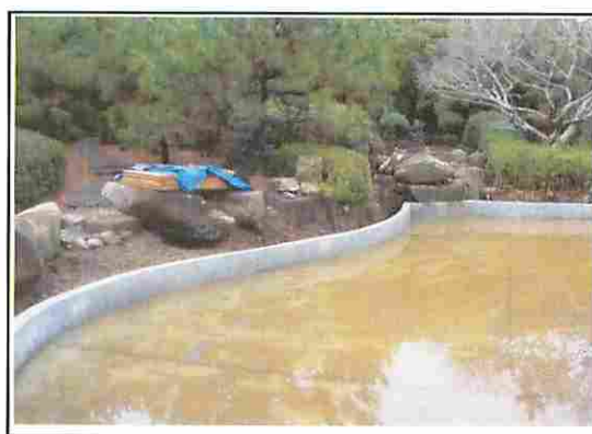
景石を仮置きした後、池の躯体全体を撤去し、再度躯体全てを作り直す方法で復旧をした
