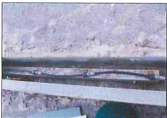
噴水前ミストのノズル(オーバーホール清掃) 清掃で済んでよかった！
