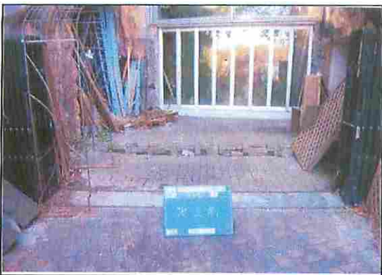
花の美術館温室裏扉前舗装(地盤沈下による インターロッキングブロックの隆起)
