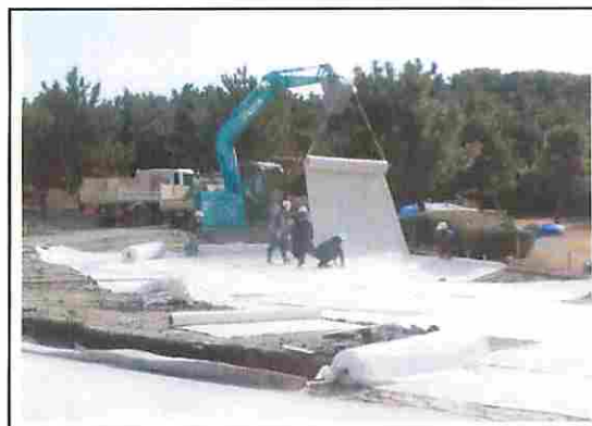
池底全体にベントナイトを含む防水シートを布設し その上に保護層としてコンクリートを打設した
