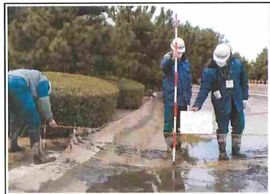
池の端部は、防水シートが持ち上げられ、部分的に破れている箇所がみられた
