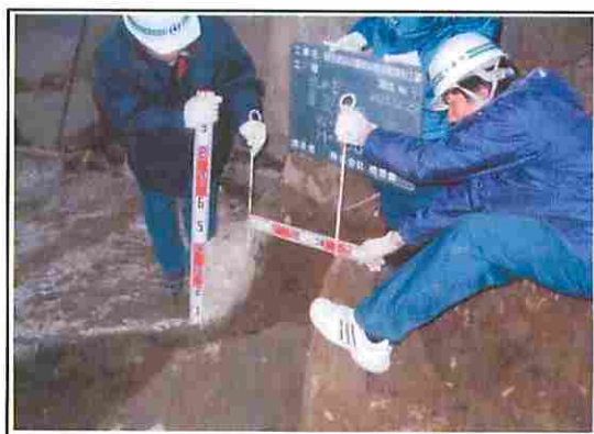
池底及び躯体の立上がり部分に、大きな破損箇所がみられた
