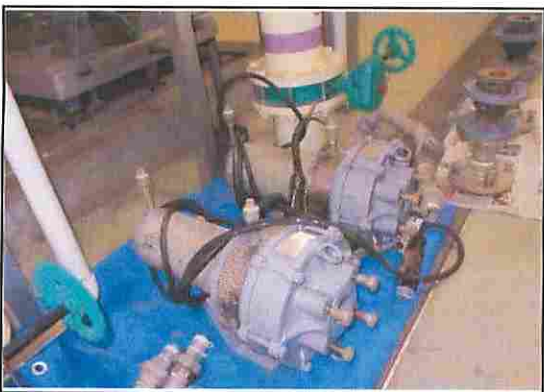
噴水のポンプ(オーバーホール清掃) 清掃で済んでよかった！
