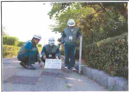
美浜公園緑地事務所前園路 (洗い出し平板舗装の段差 100mm)
