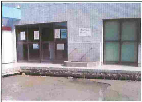
ビーチセンター(地盤沈下 370mm) 建物は約25mの深さまで基礎杭があるため 沈下せず、周囲との段差が生じた
