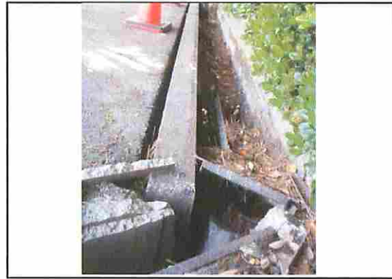
第1駐車場(側溝破損)
