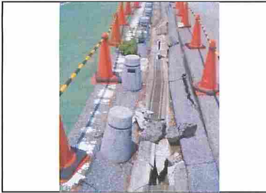
第1駐車場(地面隆起による側溝破損)
