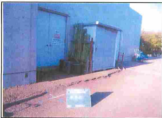
花の美術館展示棟裏 (AS舗装の段差)
