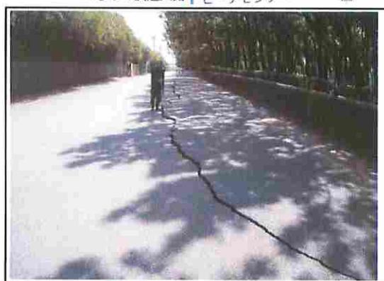
護岸道路(地面の亀裂)
