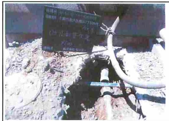
ビーチセンター建物内からの排水管の座屈 夏の海水浴時期に更衣室を利用できるように 早急に復旧
