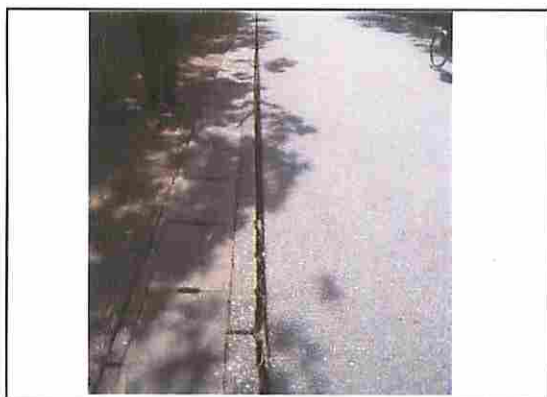
護岸道路(側溝と舗装間の空隙)
