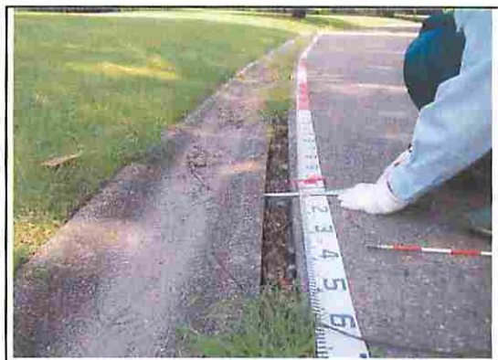
幕張海浜緑地(被害状況) 皿型側溝のずれ・沈下
