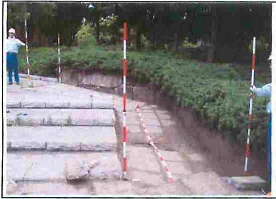
幕張海浜緑地(被害状況) 階段横のスロープは、土砂が噴出し、 部分的に沈下した
