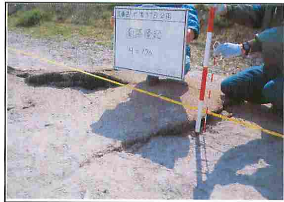
打瀬3丁目公園 チップ舗装 (被害状況) 部分的に段差が生じた
