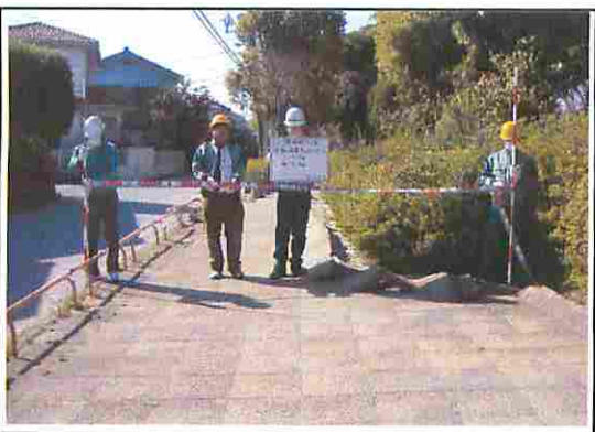
幕張西第3公園 平板舗装 (被害状況) 平板が持ち上がった
