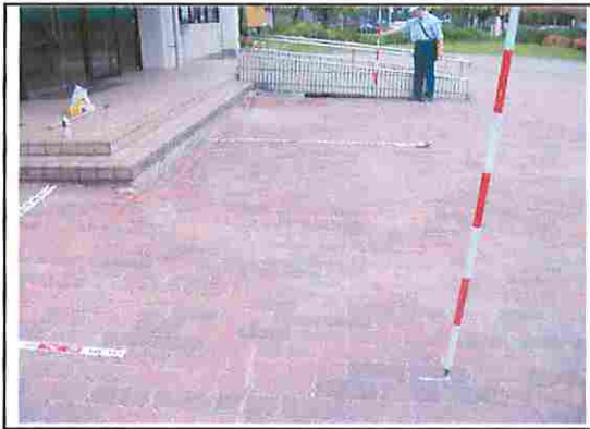
花見川緑地(被害状況)
