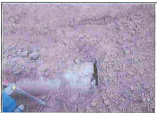
花見川緑地(被害状況) 雨水管(ヒューム管φ450)が破損していた
