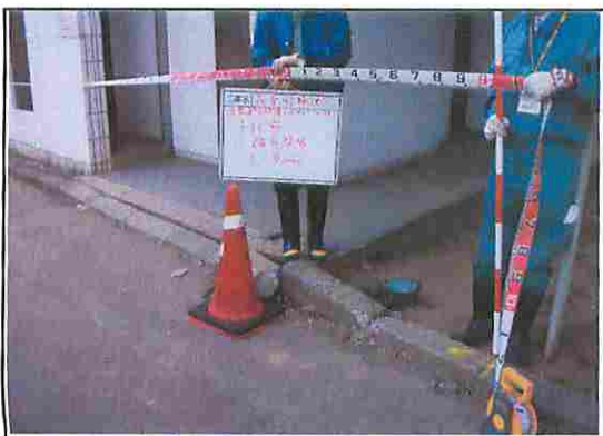
花見川緑地(被害状況)
