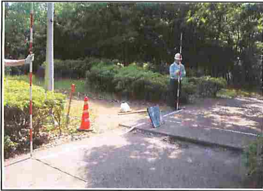
幕張海浜緑地 コンクリート舗装 (被害状況) Co舗装面が持ち上がり、 段差が生じた
