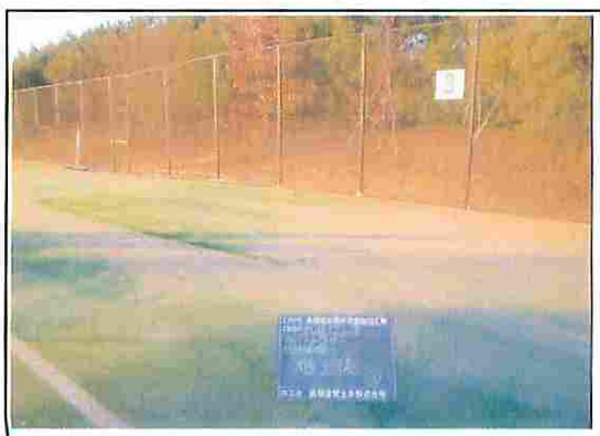
打瀬3丁目公園 テニスコート 人工芝 (復旧後)
