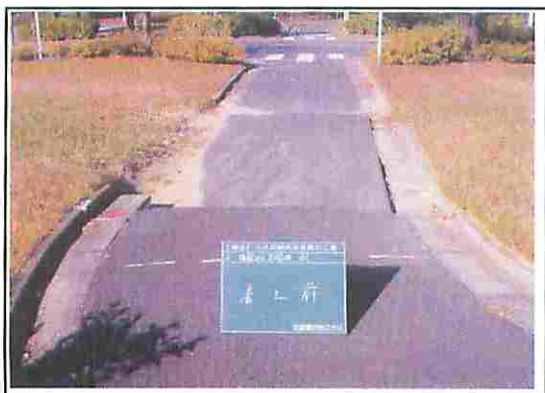
花見川緑地(被害状況) 地表面がこんな状態だと、地下埋設物は→
