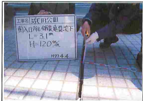
浜田公園 タイル舗装 (被害状況) 基盤の舗装に亀裂が生じた
