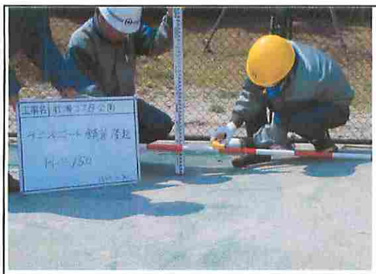
打瀬3丁目公園 テニスコート 人工芝 (被害状況)部分的な隆起がみられた
