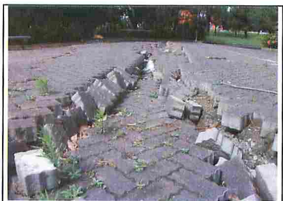
花見川緑地 インターロッキングブロック舗装 (被害状況)
