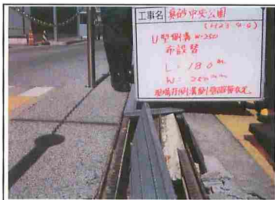
真砂中央公園(被害状況) 現場打ちU型側溝の破損
