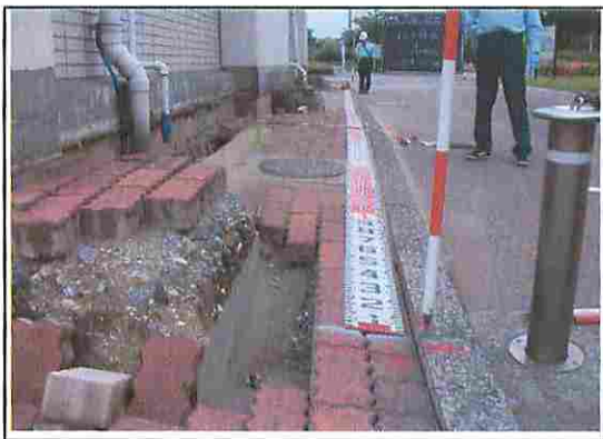
花見川緑地(被害状況)
