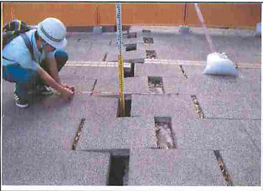
幕張海浜緑地 自然石舗装 (被害状況) 基盤の舗装に亀裂が生じた
