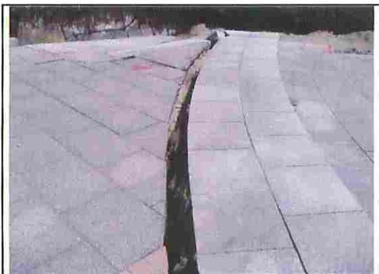
幕張海浜緑地(被害状況) 表面上確認できない、躯体のコンクリート部分 にも、多数のクラックがみられた
