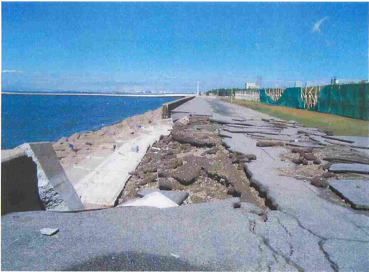
台風の高波により、護岸が26mに渡り、損壊した。
