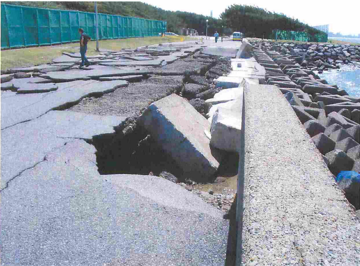
舗装復旧工事を実施予定であった、護岸道路の路盤が波で流失した。
