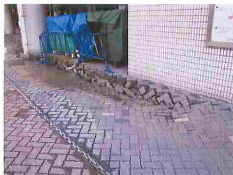
③インターロッキングブロック舗装破損
