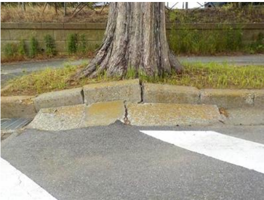
根上りによる道路施設の破損
