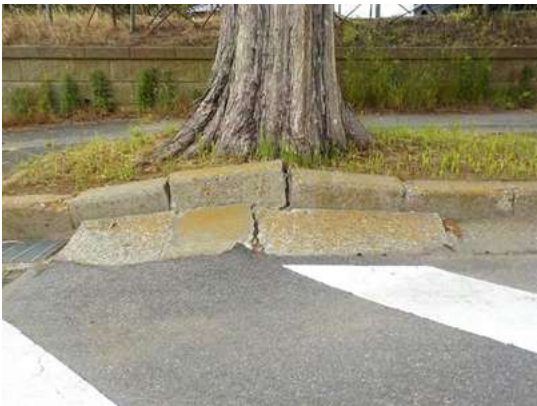
根上りによる道路施設の破損
