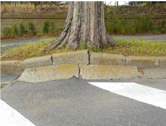
根上りによる道路施設の破損
