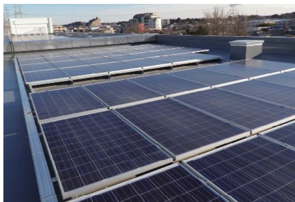
太陽光発電設備（学校の屋上に設置されたもの）
