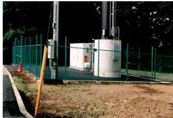
緑系のフェンスが目立つ。 生垣がないと設備類が見え、景観を損ねる。
