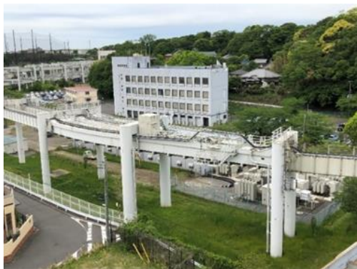
図 4-6 殿台変電所全景
