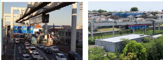
モノレールへの電力供給を担う殿台変電所 2021(R3)年度に電力貯蔵装置導入完了
