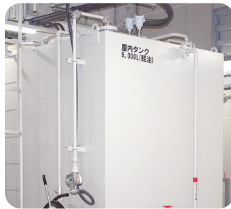
屋内オイルタンク
