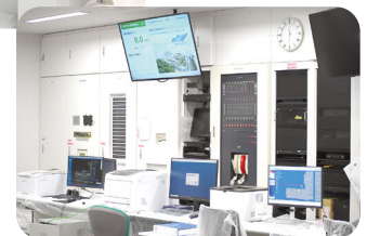
防災センター
