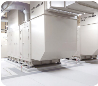
非常用発電機
