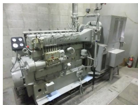
本庁舎地下 1 階 非常用発電機
