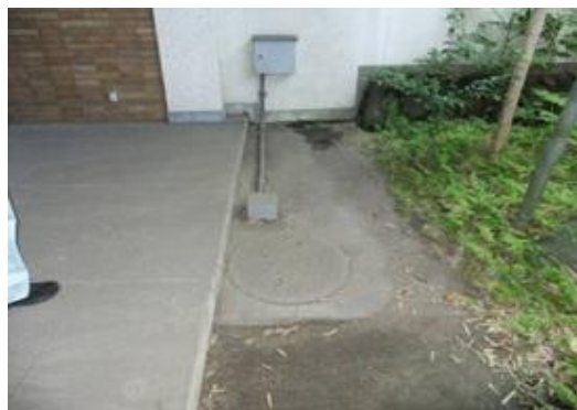
本庁舎屋外 汚水槽
