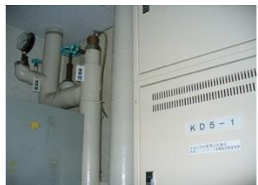
本庁舎 5 階 情報通信機器盤
