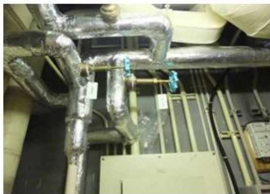
議事堂棟機械室(電気配電盤の上に配水管)
