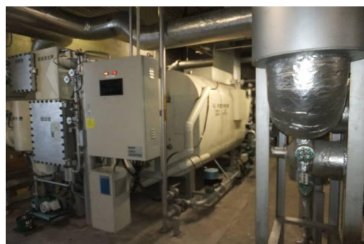
本庁舎地下1階 ガス吸収式冷暖房機
