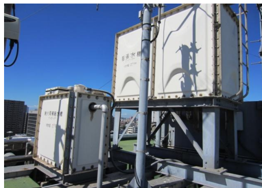
本庁舎屋上 消火補給水槽
