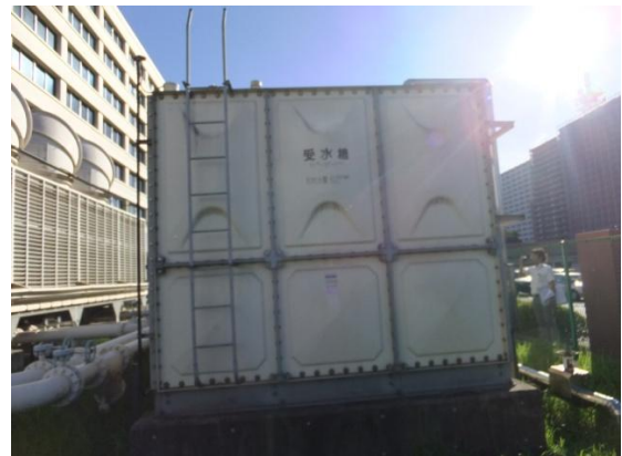
本庁舎屋外受水槽
