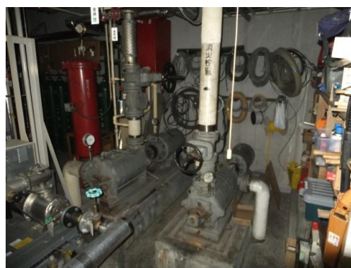
本庁舎地下1階 屋内消火栓ポンプ
