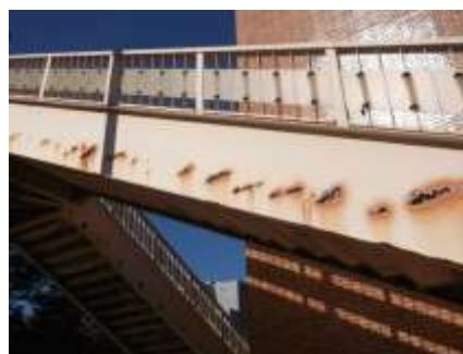
老朽化の状況
