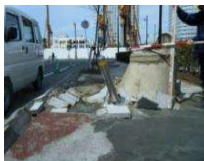
東日本大震災による マンホール浮上の被害
