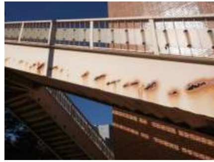
老朽化の状況
