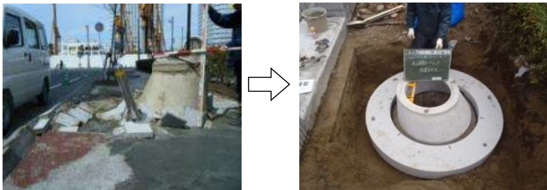
東日本大震災による マンホール浮上の被害
