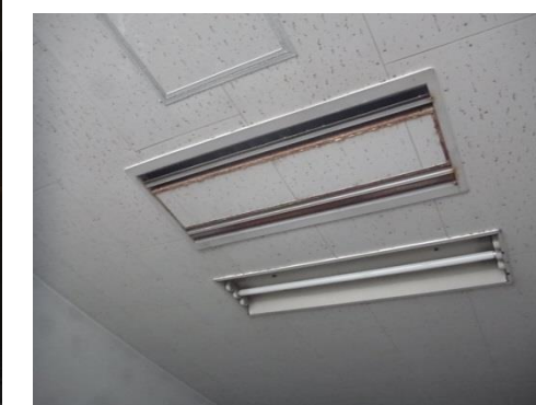
【既存空調機、既存照明】
