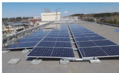
学校屋上に設置した太陽光パネル
