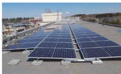
学校屋上に設置した太陽光パネル
