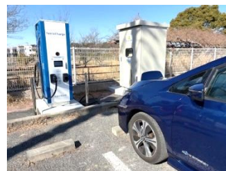
花見川区役所駐車場 EV用充電設備
